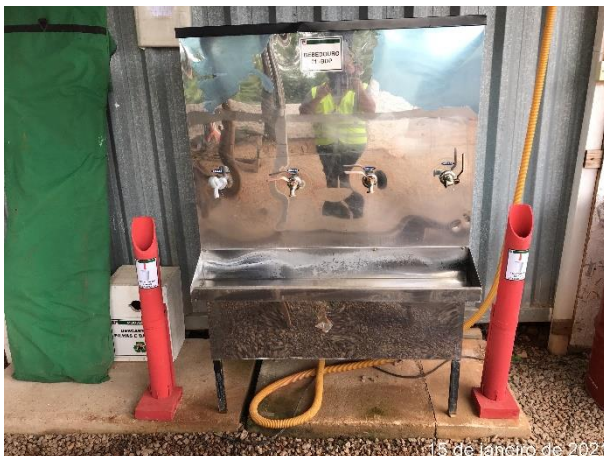
Foto 63 – Limpeza do bebedouro. (Data:15/01/2021)
