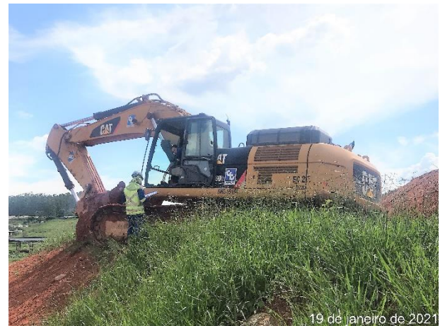
Foto 70 – Checklist Escavadeira hidráulica. (Data: 19/01/2021)
