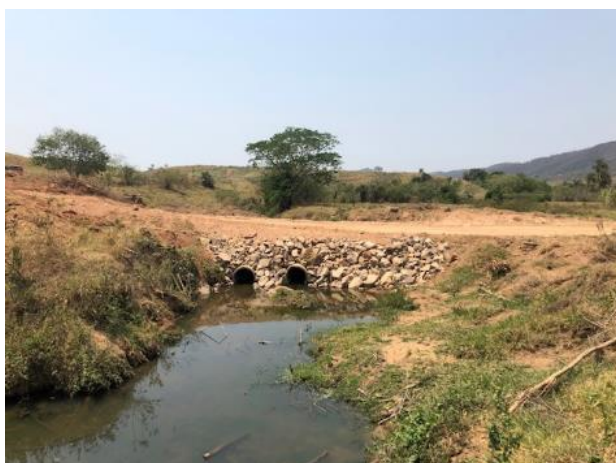
Foto 101 – Passagem Molhada córrego Pantaleão (Data: 21/10/20)
