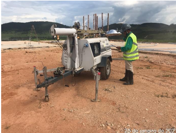
Foto 69 – Checklist Torre de iluminação. (Data:25/01/2021)
