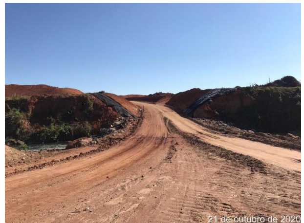
Foto 100 – Passagem Molhada rio Camanducaia (Data: 21/10/20)
