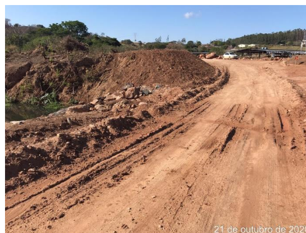
Foto 110 – Passagem Molhada Rio Camanducaia (Data: 21/10/20)
